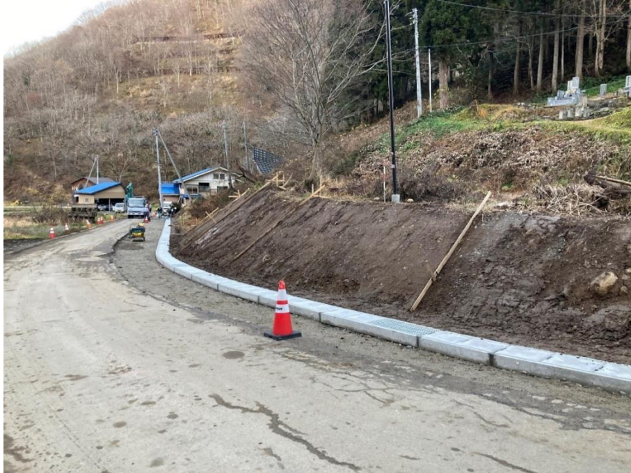
写真 4-16 道路脇に成立していたフクジュソウ Adonis ramosa 群落が道路拡幅工事により失われた（2022 年、布沢・大田）。工事計画段階でユネスコエコパーク推進係を窓口にした調整が求められる。
